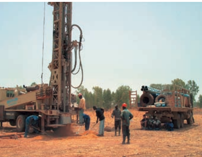
Deux forages ont été réalisés en 2009, sur des sites qui accueilleront de nouvelles écoles.
